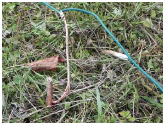
地面に差し込まれたアース
